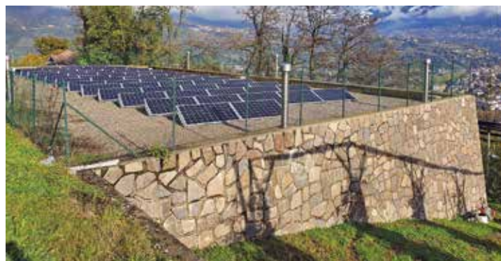
Photovoltaikanlage auf dem Dach des Trinkwasserspeichers „Knorzner“
